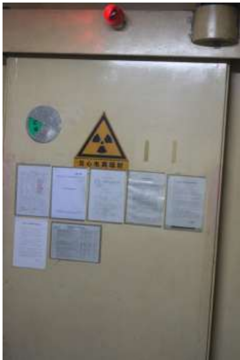
探伤室小防护门
