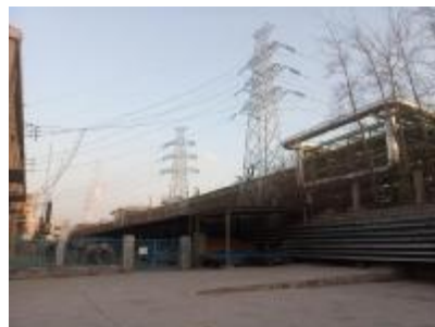
110kV I 配电装置南侧
