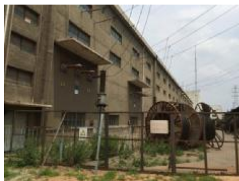
图 5 待改造的 110kV 配电装置
