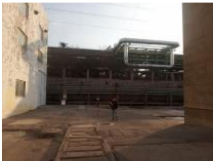
110kV I 配电装置东侧
