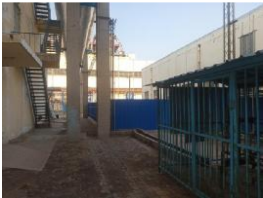
110kV II 配电装置东侧
