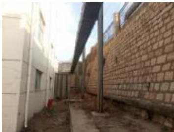
现有 220kV 变电站配电装置南侧
