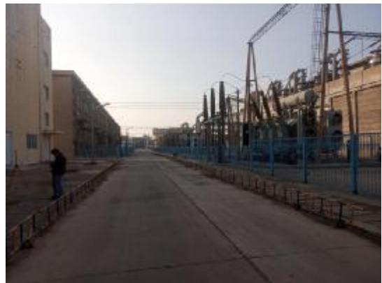
110kV II 配电装置北侧
