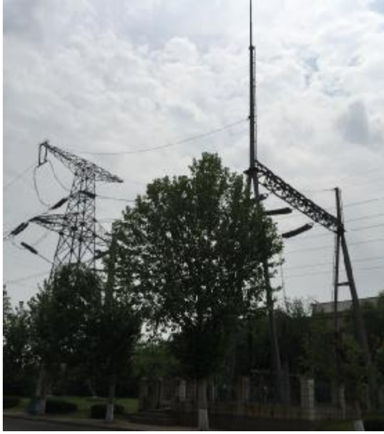
图 2 220kV 烯化线终端站
