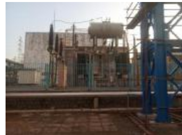
现有 220kV 变电站变压器区北侧
