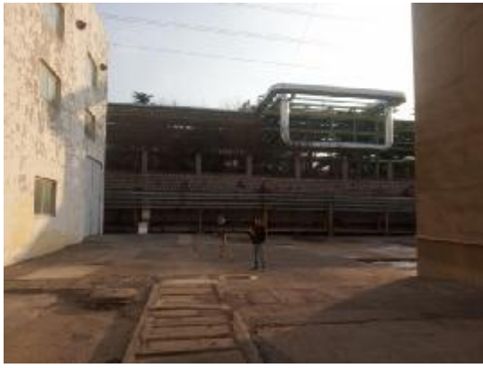
110kV II 配电装置西侧
